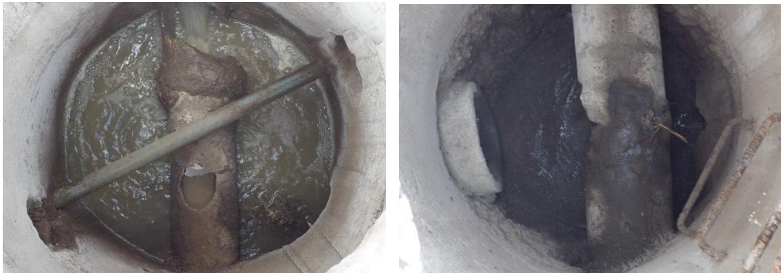
FOTOS Nos. 15 y 16: ESTADO ACTUAL DE LAS TUBERÍAS.
