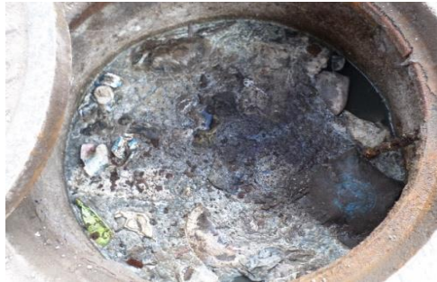
FOTO No. 13.- POZO LLENO DE BASURA
