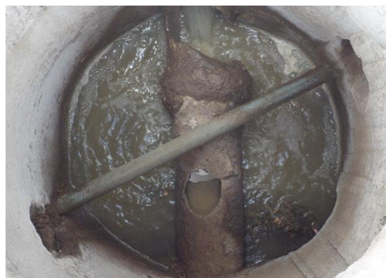
FOTO No. 10.- ESTADO ACTUAL DE LAS TUBERIAS
