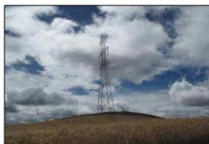
Foto 3.2.2 Línea de transmisión
