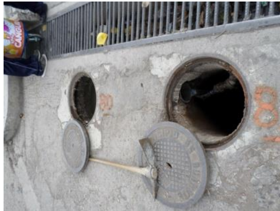
FOTO No. 1.- POZOS DE REVISIÓN
