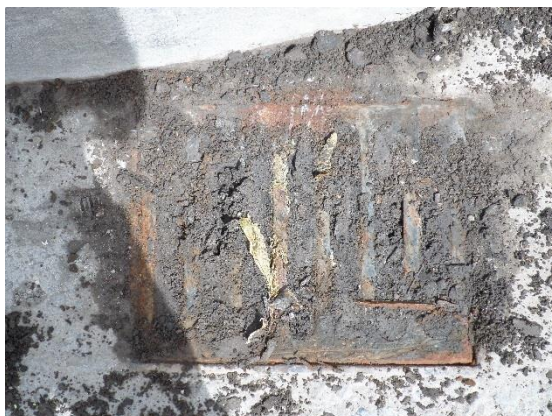
FOTO No. 18.- SUMIDERO LLENO DE AGUA
