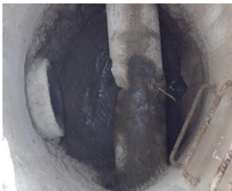
FOTO No. 9.- TUBERIA Y POZO COLAPSADO
