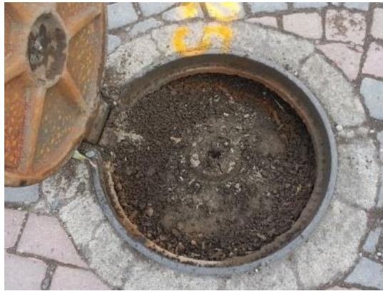
FOTO No. 6.- POZO TAPONADO Y COLAPSADO
