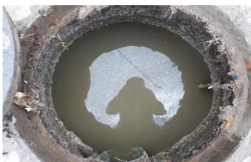
FOTO No. 12.- POZO LLENO DE AGUA Y BASURA
