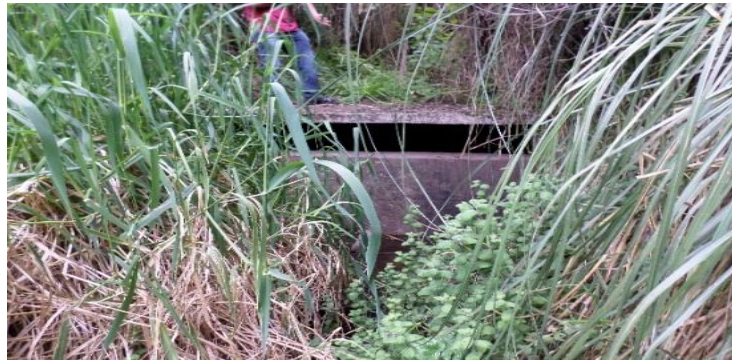
FOTOS N° 2 TANQUE DE UNIÓN DE CAUDALES SANTA ROSA
