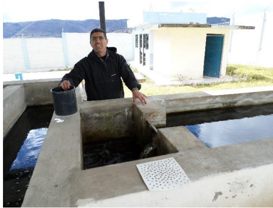
FOTOS N° 10 INGRESO DE CAUDALES DE SANTAS ROSA AL FILTRO
