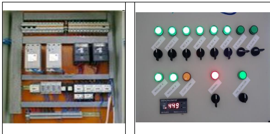
FIGURA N° 9.- TABLEROS DE CONTROL
