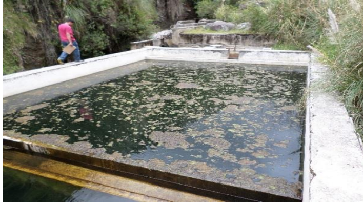
FOTOS N° 3 DESARENADOR CAPTACIÓN MATIPANGA
