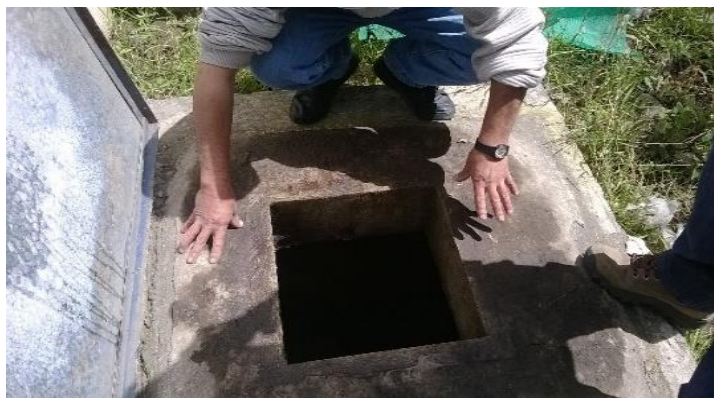
FOTOS N° 7 CAPTACIÓN CHIPO CHICO
